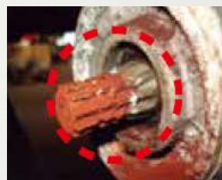
凍結防止剤に侵入による錆
